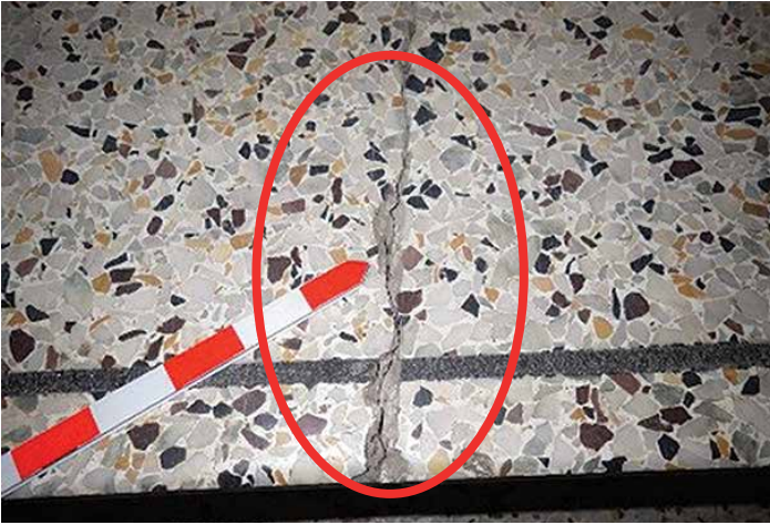
Fissure dans une marche
