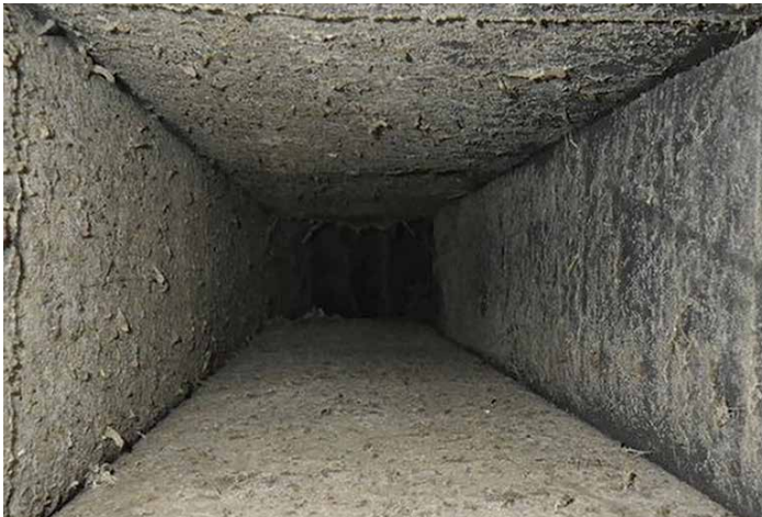
Conduit de ventilation ayant besoin d'entretien
