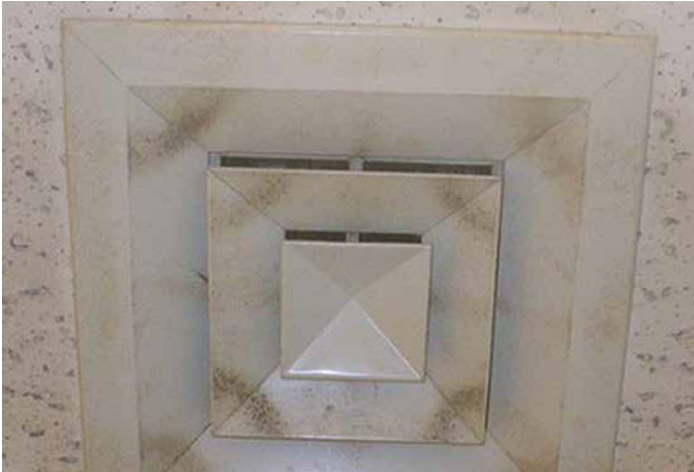
Bouche de ventilation ayant besoin d'entretien
