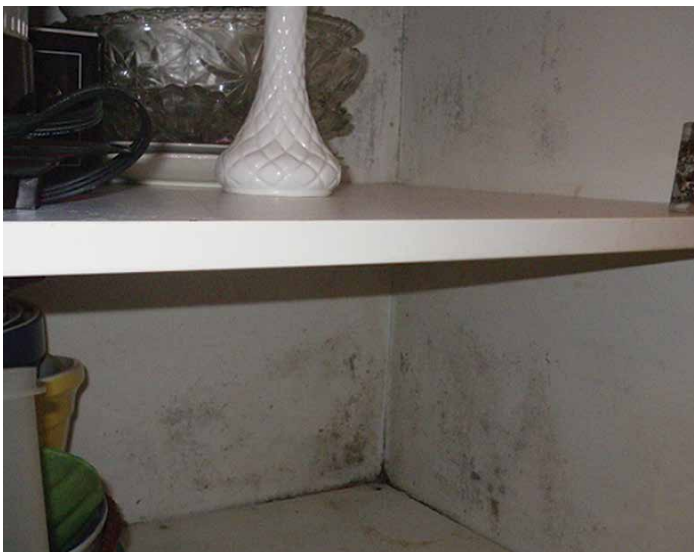
Présence de moisissures dans une armoire de cuisine
