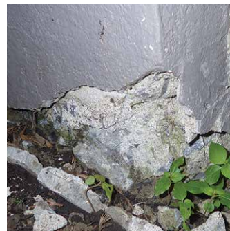
Dégradation d'un coin de fondation
