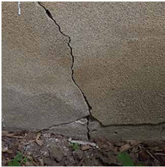
Fissure dans la fondation
