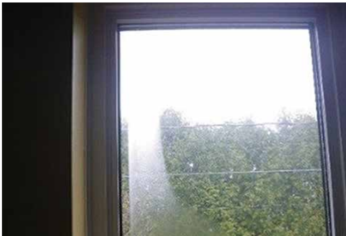
Buée entre les thermos d'une fenêtre
