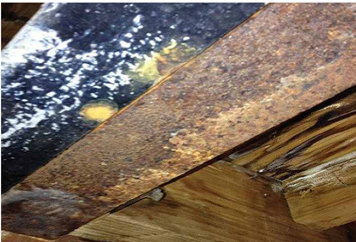
Structure d'acier endommagée sous un balcon
