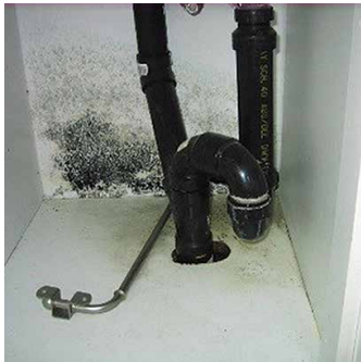
Dessous d'évier avec moisissures
