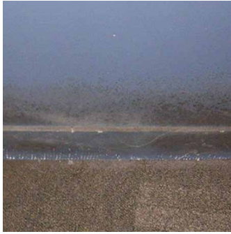
Moisissures dans le bas d'un mur
