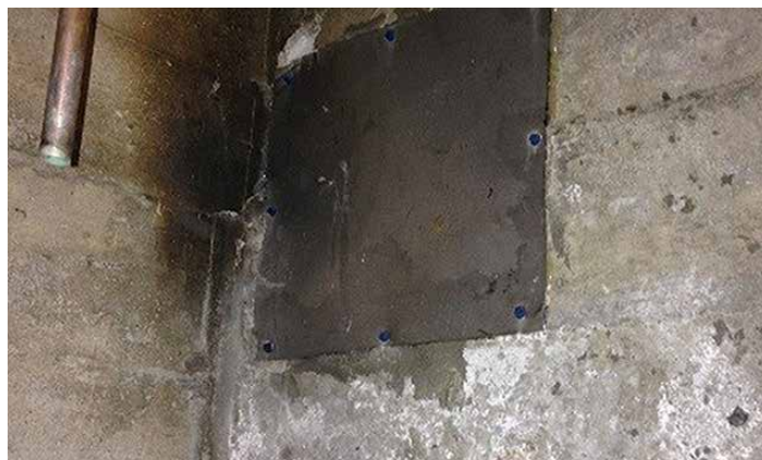
Efflorescence et cernes d'humidité dans un sous-sol
