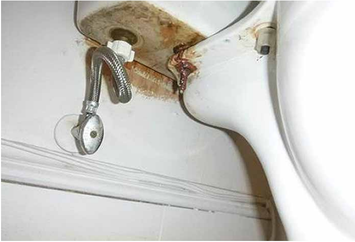
Fuite d'eau sous le réservoir d'une toilette
