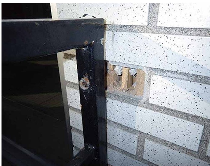
Garde-corps mal fixé au mur extérieur
