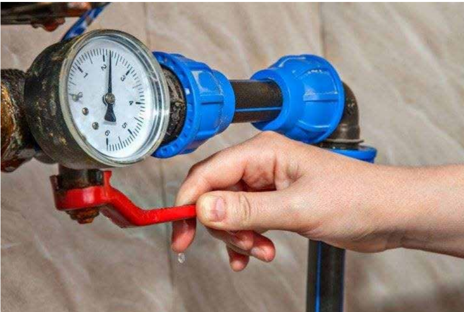
Valve de l'entrée d'eau principale avec manomètre de contrôle de pression d'eau
