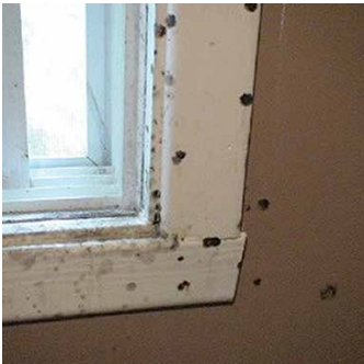
Cadrage de fenêtre avec moisissures
