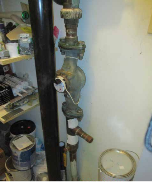
Entrée d'eau à l'intérieur du bâtiment
