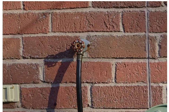
Robinet d'arrêt d'eau extérieur
