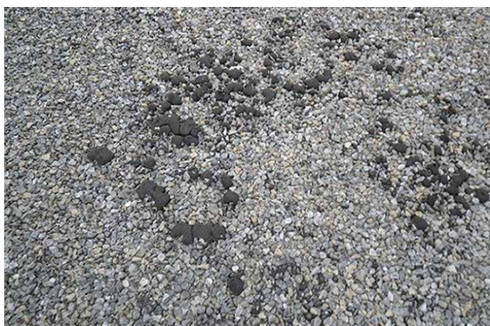
Bulles d'asphalte en surface
