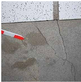
Petite fissure de crépis
