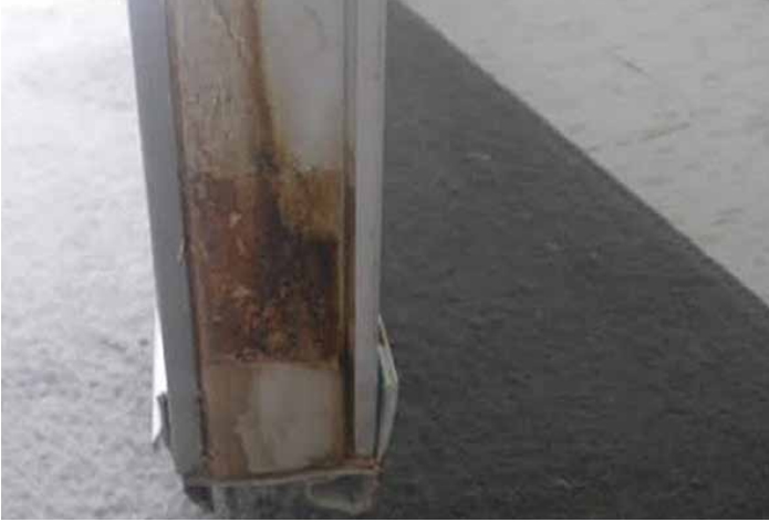
Traces d'humidité sur une porte
