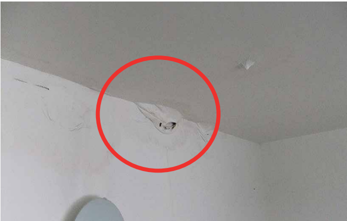
Infiltration d'eau sous la peinture
