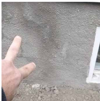
Cernes d'humidité sur une fondation
