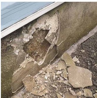
Dégradation du crépi
