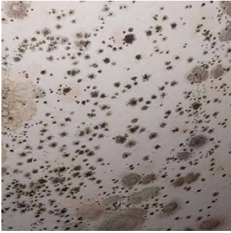
Plafond recouvert de moisissures
