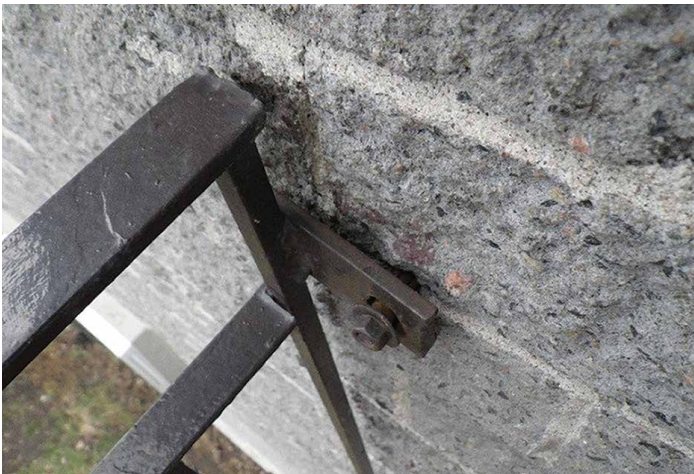
Garde-corps mal fixé
