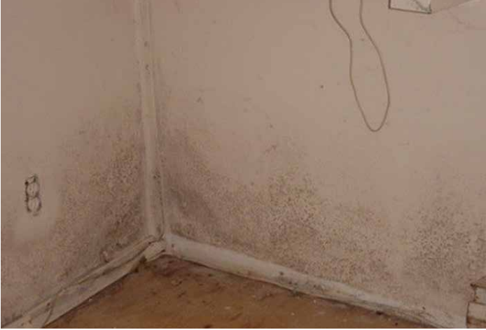
Mur couvert de moisissures
