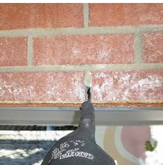
Chantepleure partiellement obstruée
