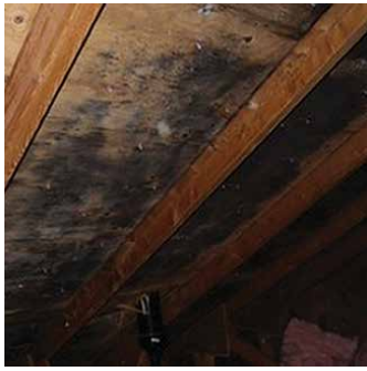
Cernes d'humidité dans un entretoit
