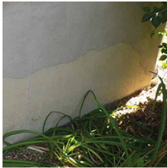
Dégradation du crépi
