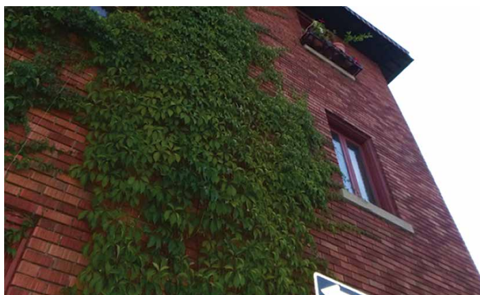
Vigne sur un parement de brique
