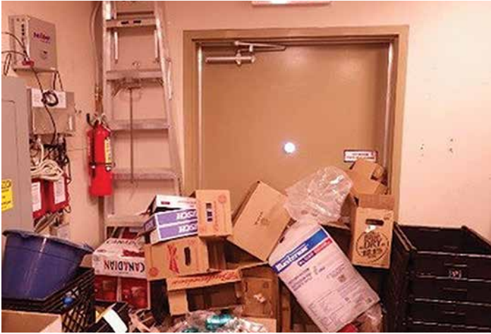
Sortie d'urgence non accessible
