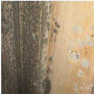
Moisissures sur un cadrage en bois
