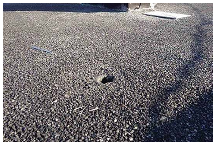
Drain de toit sans grille
